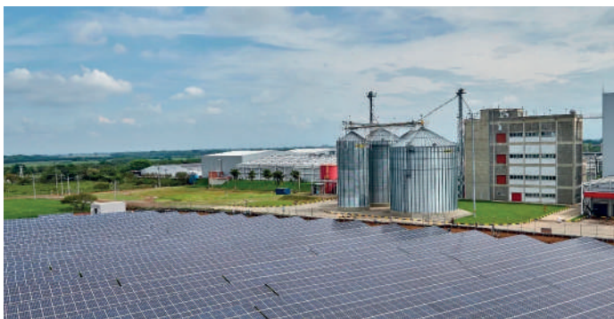
Colombina Energía E.S.P. Autogeneración Solar La Paila
